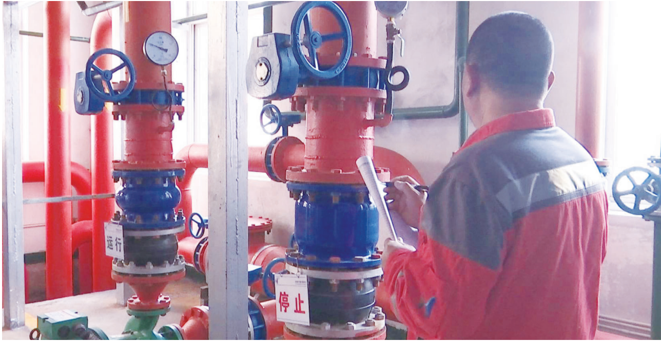
工作人员查看供热设备(11月1日摄)。本报记者 班占洋 摄
