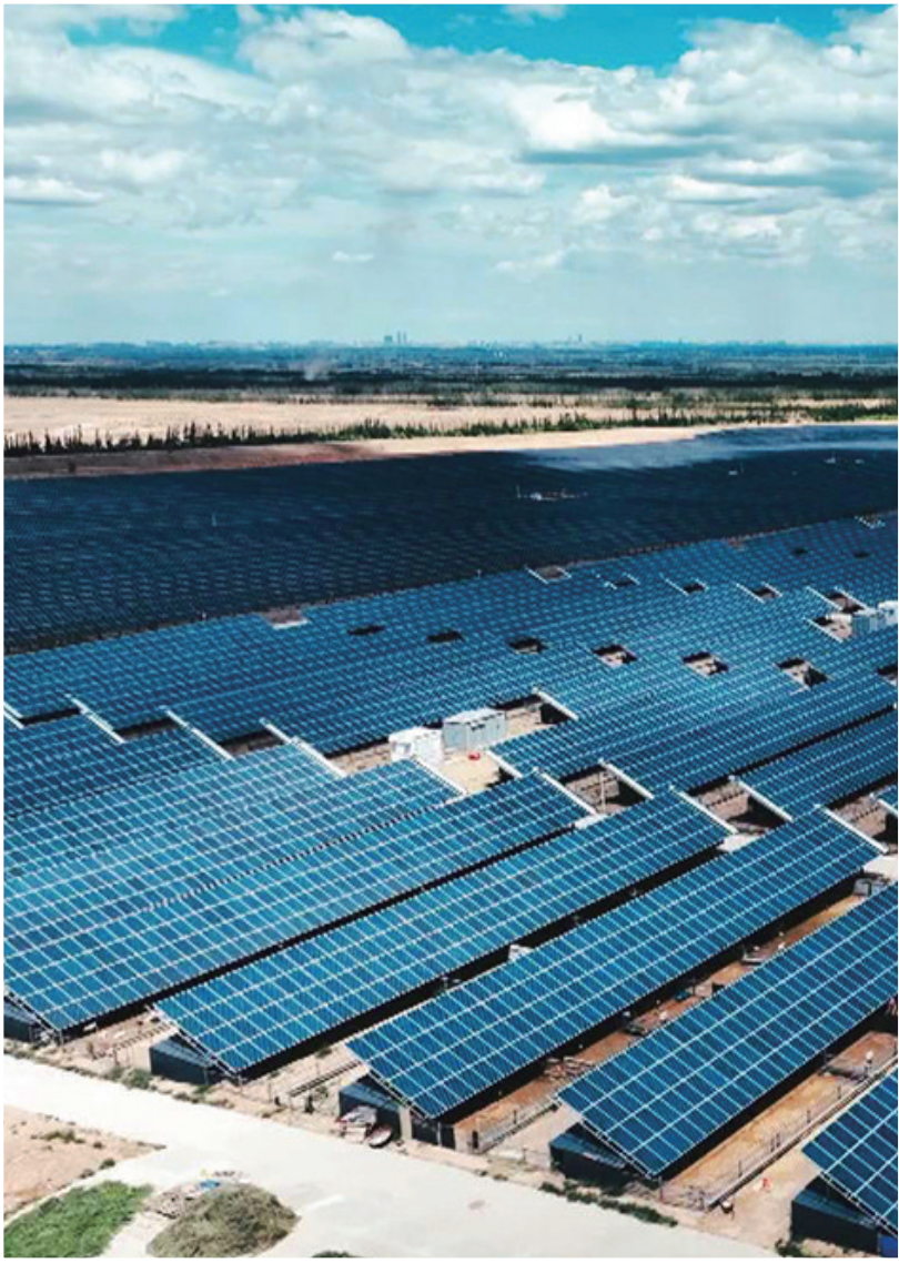
闽宁镇光伏项目。
