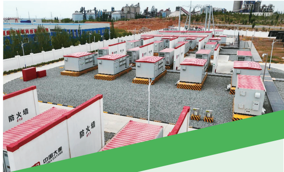
大唐闽宁共享储能电站平稳运行。
