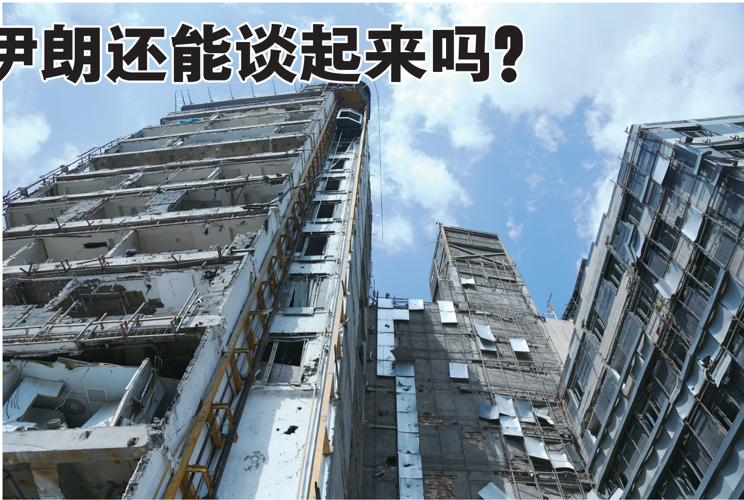
这是4月20日在伊朗首都德黑兰拍摄的在美以袭击中被损毁的甘地医院。新华社发
