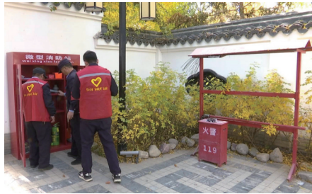
志愿者对微型消防站进行检查。
