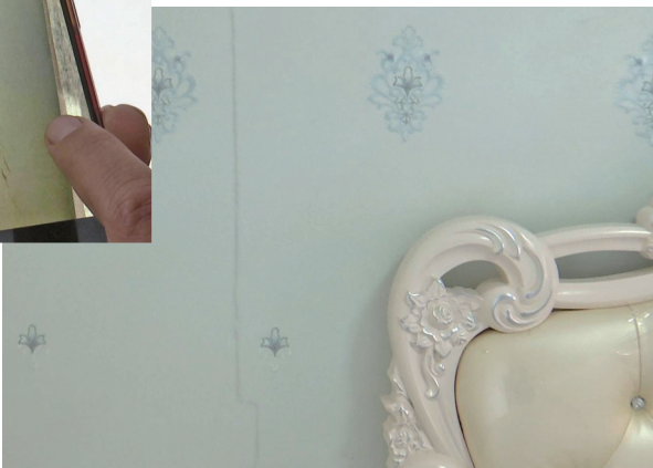
↑ 房屋墙面出现裂缝。
