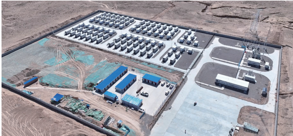
宁夏电投新能源有限公司青龙山 200MW/400MWh 新能源共享储能电站示范项目。
