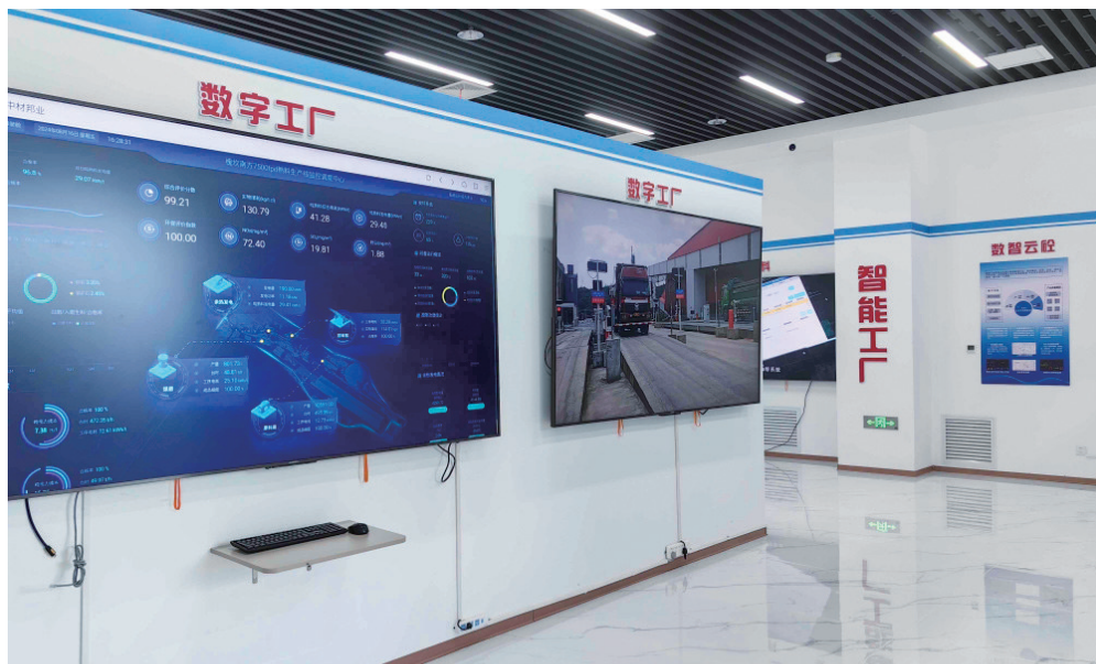
中国建材互联网产业园数据中心项目内景。
