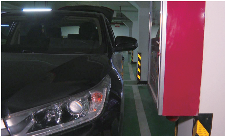
消防箱紧挨车位，影响车辆停放和消防箱的使用。
