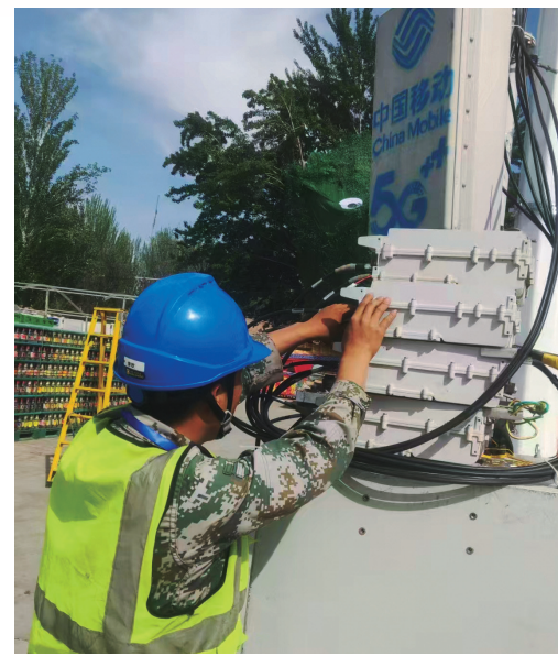
工作人员正在巡检设备。
