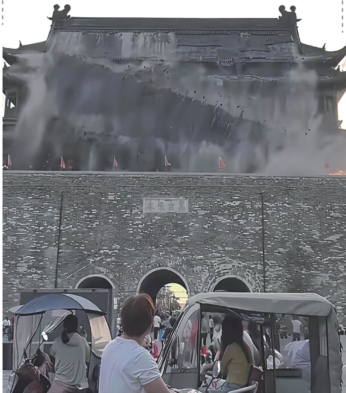
凤阳鼓楼楼宇瓦片脱落，扬起烟尘。
