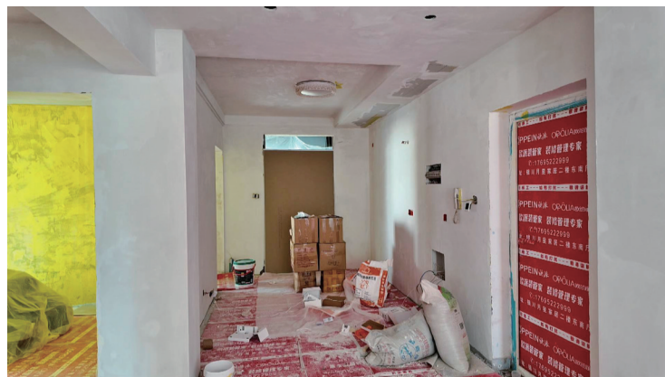
装修中途停工。
